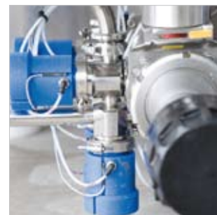
Automaattiset venttiilit maidon ja pesuvesien ohjaukseen
